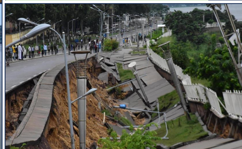
Effondrement de la route de la corniche à la suite des précipitations
